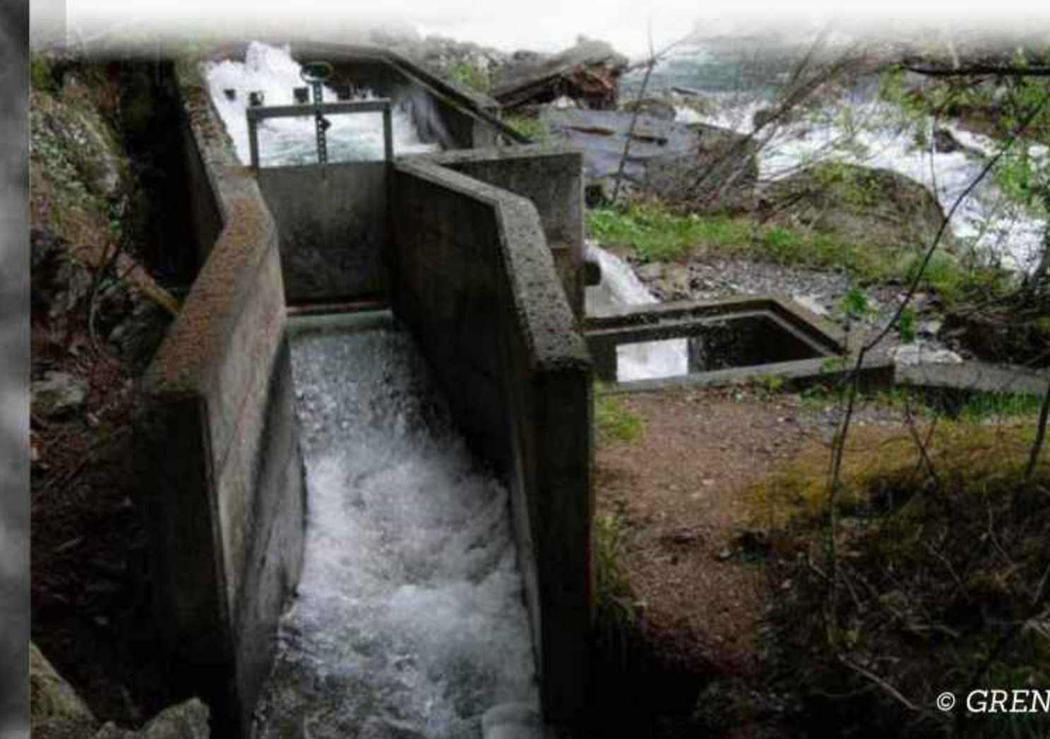
Prise d'eau du Bénou dans la Raspille Wasseranschluss des Bénou an der Raspille
